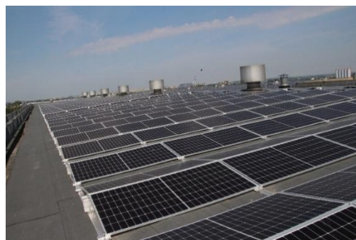
Fot. 13 Elektrownia fotowoltaiczna o mocy 1,1 MW (Lublin)
